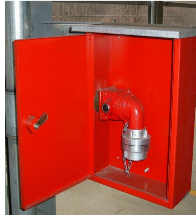
Steigleitung, trocken für Feuerwehr
